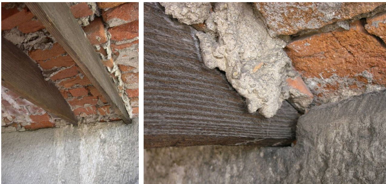
Obr. 1 a 2. Hrad Pernštějn, spodní část ochozu, zděná cihelná klenba se zbytky vyteklé středověké zdicí malty. Detail zděné cihelné klenby se zbytky vyteklé středověké malty
