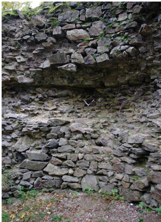
Obr. 7. Zdivo jižní věže hradu Hamrštšjna s patrným defektem patrně v místě přerušení stavby, které indikuje výskyt izolační hliněné vrstvy cca uprostřed zdiva.
