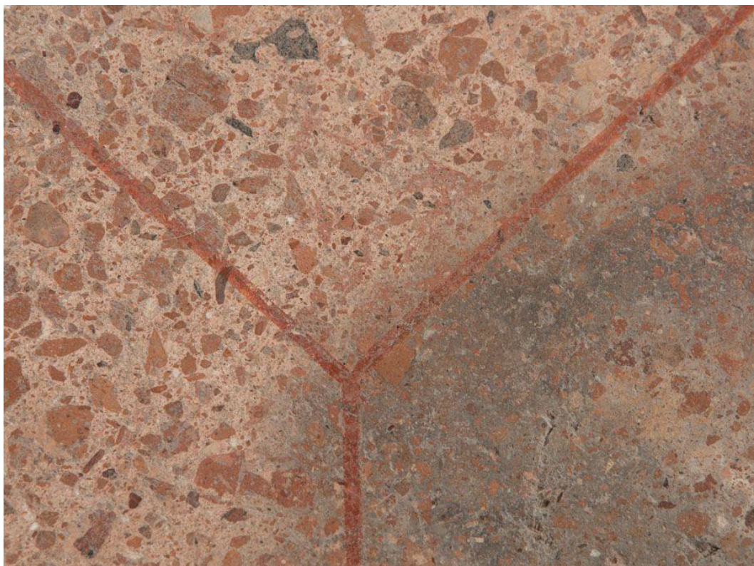
Obr. 5 Detail podlahy typu benátského terrazza (16. stol.), letohrádek Hvězda, Praha. Vpravo místo poškozené ohněm.
